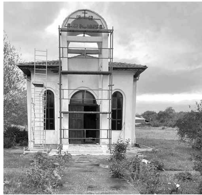
Ремонтира се църквата „Св. Павел и Петър“ в Раковсково ФОТО: ОБЩИНА НЕСЕБЪР
